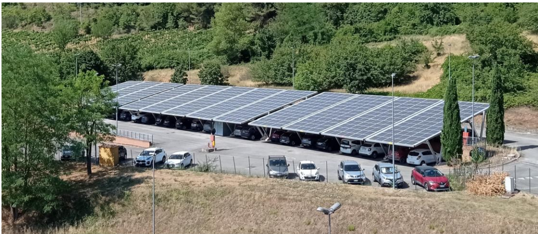
Figura 8. Carport Fotovoltaico realizzato da CET Ospedale di Poggibonsi, Azienda USL Toscana Sud Est
