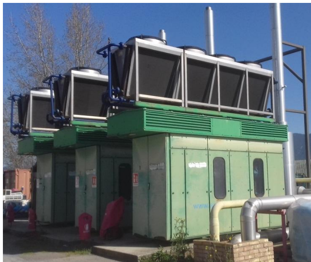
Figura 7. Gruppi di cogenerazione CT4, AOUP
