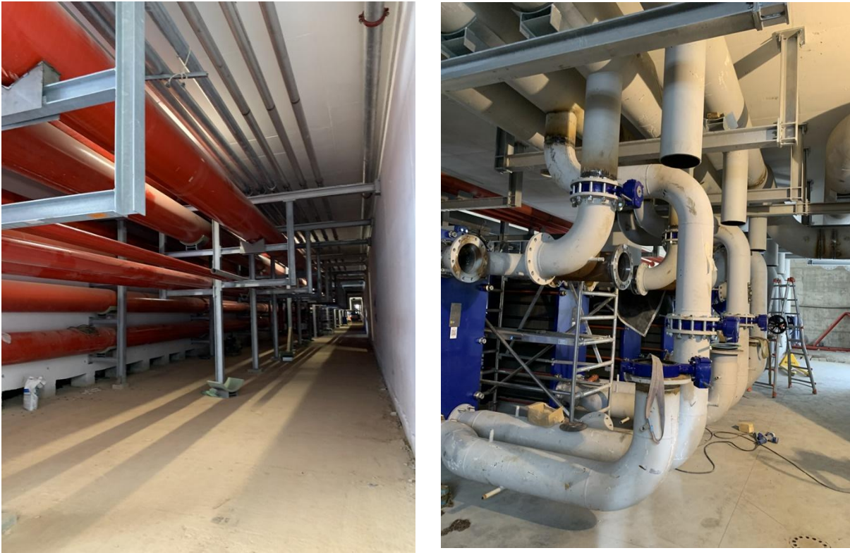
Figura 1. Vista dell'impianto della rete di teleriscaldamento del Nuovo Ospedale di Cisanello, Azienda Ospedaliera Universitaria Pisana
