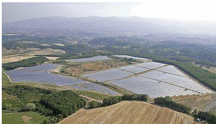
Figura 4. Impianto FV di Santa Barbara a Cavriglia
