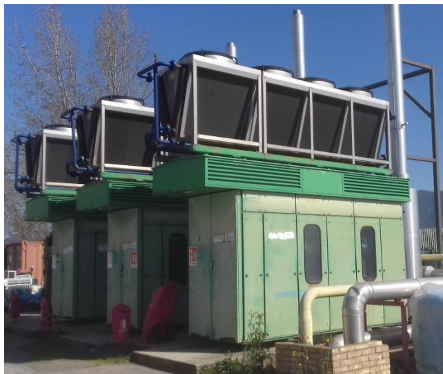
Figura 11. Gruppi di cogenerazione CT4, AOUP
